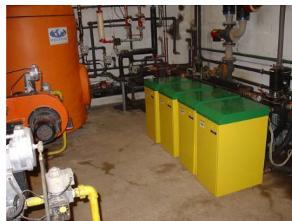
3 PAC sont dédiées au bassin de nage, 1 à la production d'ECS
