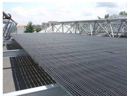
Le capteur solaire en EPDM est posé sur un support métallique en toiture
