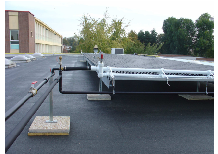
Le capteur solaire est ici fixé sur un support en acier galvanisé
