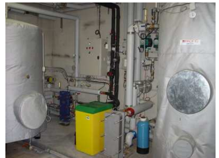
Local technique : PAC solaire et 2 ballons de stockage ECS
