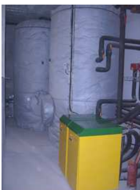
2 PAC eau/eau au 134a de 12kW unitaire assurent la production d'eau chaude
