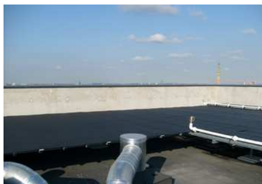
Le capteur solaire, fabriqué sur mesure pour répondre aux contraintes d'implantation, est fixé sur un support métallique en toiture.
