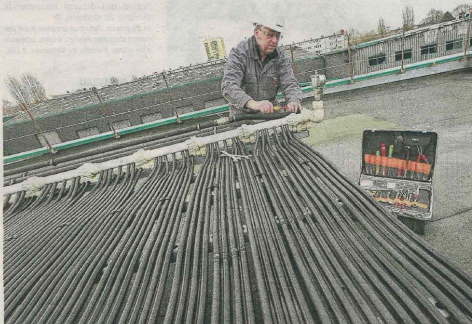
Les capteurs solaires d'Héliopac peuvent être implantés sur une toiture terrasse, une couverture métallique, un toit incliné, un caillebotis, en pergola... Ils peuvent également être implantés en terre-plein, à proximité d'un bâtiment. PHOTO HUBERT VAN MAELE
