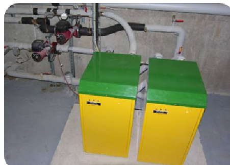
2 PAC eau/eau au 134a de 12kW unitaire assurent la production d'eau chaude sanitaire des 80 logements du bâtiment B.
